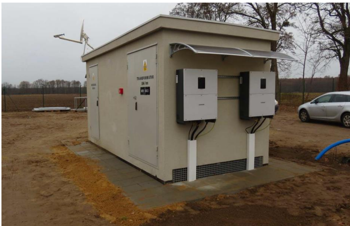
Rysunek 7. Przykładowa stacja transformatorowa z zainstalowanymi inwerterami
